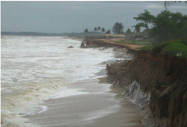
Figure 8 : Érosion côtière à Grand-Lahou
